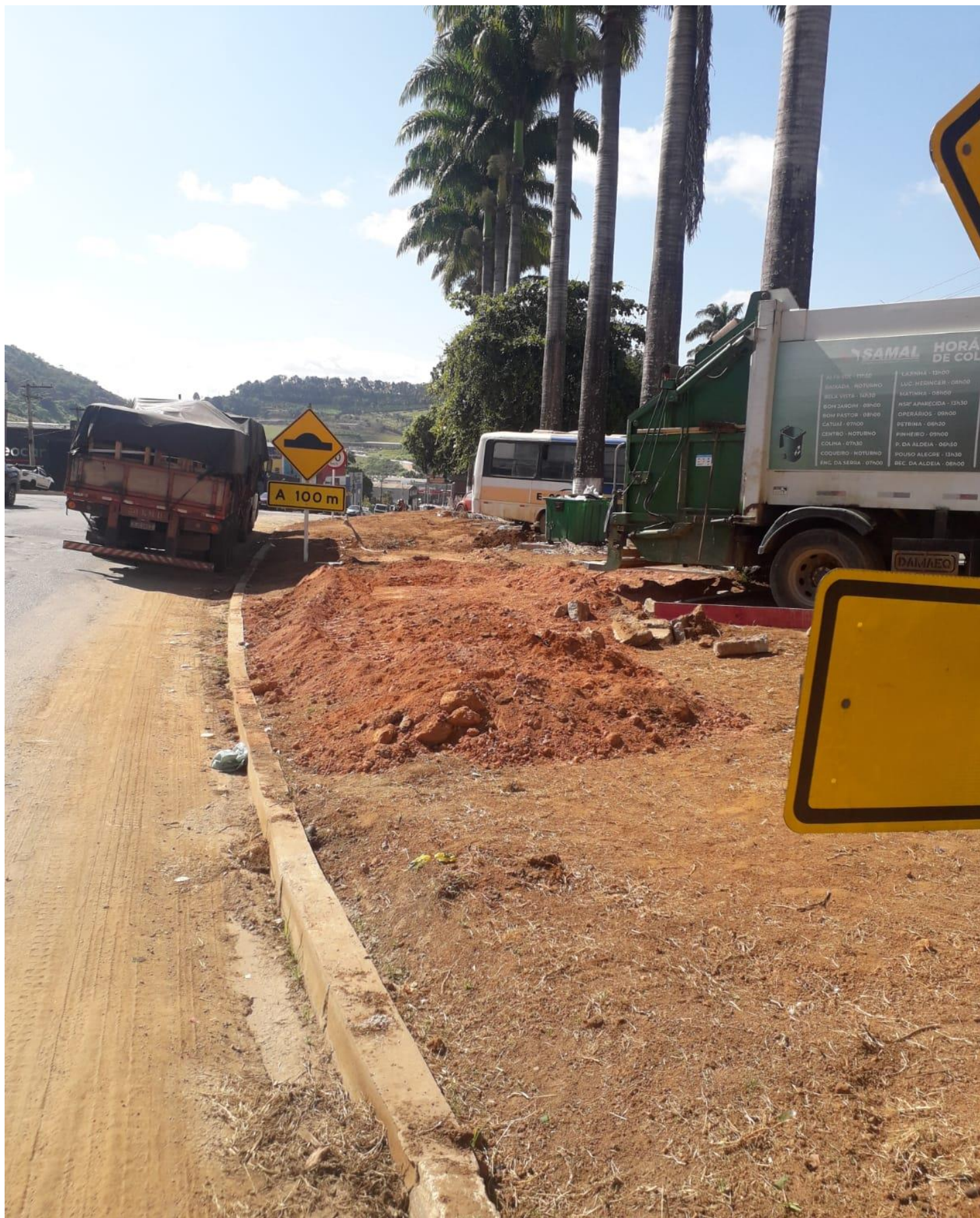
Material de desaterro na lateral da faixa de rodagem da BR 262 sem autorização do DNIT, usando material humano Municipal, materiais de construção comprados com dinheiro publico e maquinas a serviço do Município. Coordenadas Google maps: -20.256067, -42.028313.
