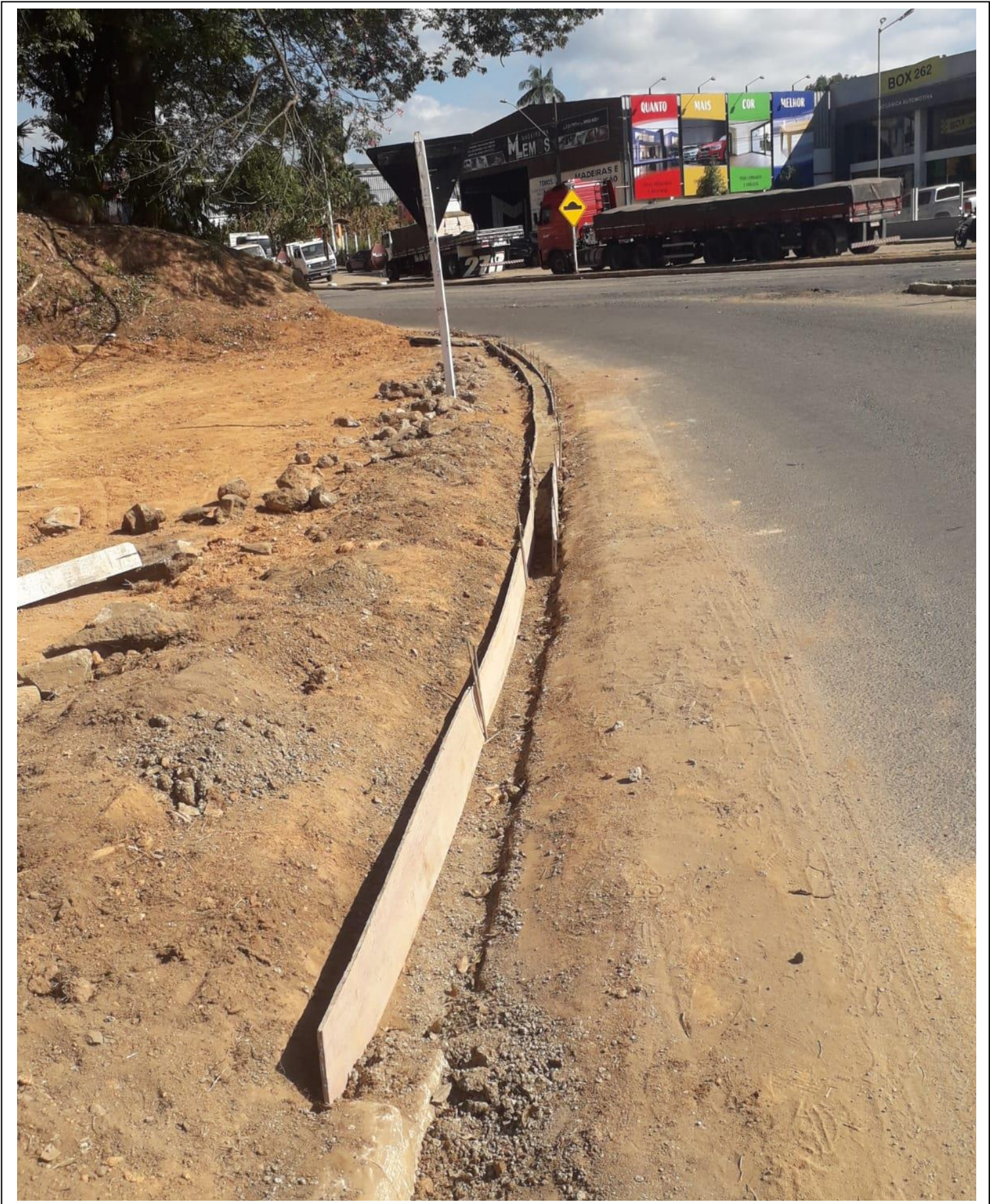
Processo mal feito de meio fio nas laterais do trevo do zebu BR 262 sem autorização do DNIT, com material humano Municipal, materiais de construção comprados com dinheiro público e máquinas a serviço do Município. Coordenadas Google maps: -20.257657, -42.024737-.
