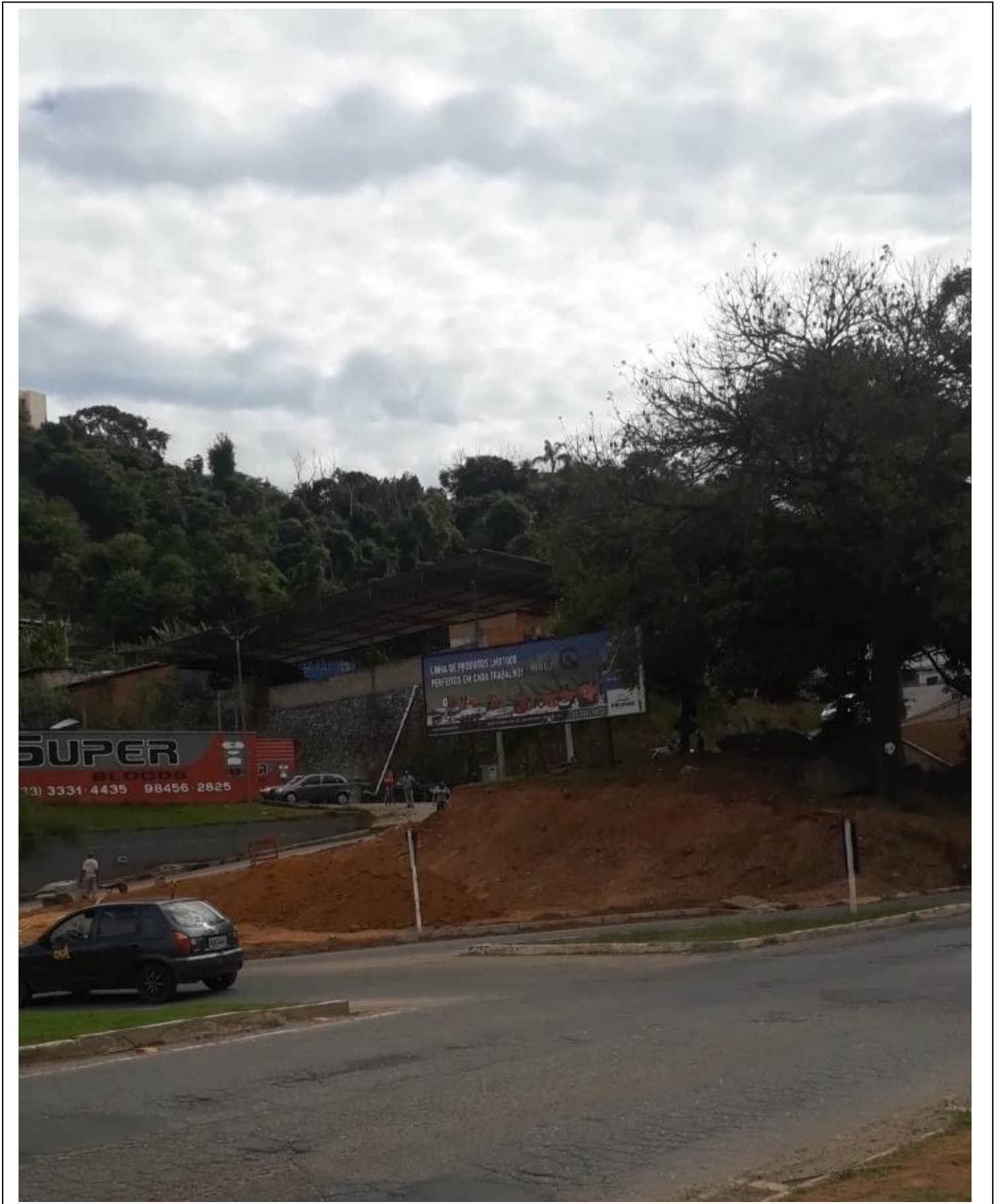
Vista de Trabalhadores Municipais manuseando materiais nos arredores do trevo do zebu BR262 sem autorização do DNIT, com material humano Municipal, materiais de construção comprados com dinheiro público e máquinas a serviço do Município. Coordenadas Google maps: -20.257657, -42.024737-.
