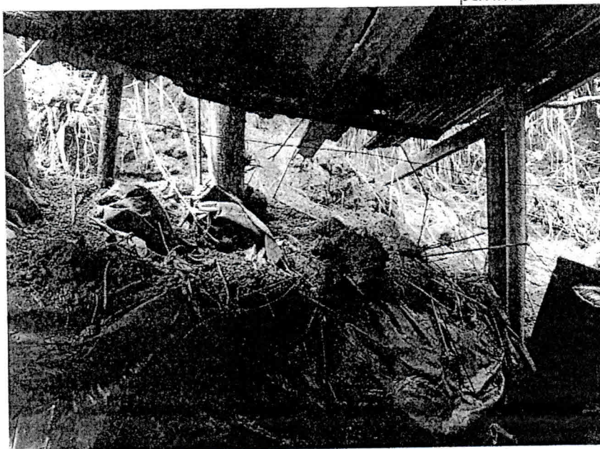
Figura N° 06 – Erosão na superfície do talude.
