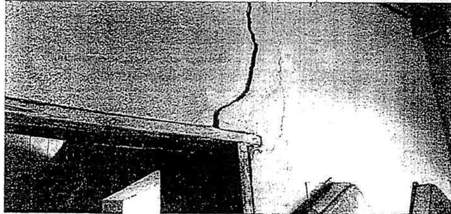
FIGURA Nº 01 – Rachadura na alvenaria, comprometendo o telhado.
