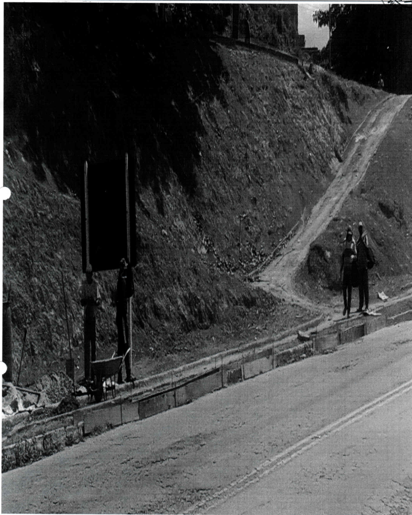
Trabalhadores Municipais fazendo partes dos meios fios na parte da rodovia BR 262 sem autorização do DNIT, com material humano Municipal, materiais de construção comprados com dinheiro publico e maquinas a serviço do Município. Km 34+300 metros .
