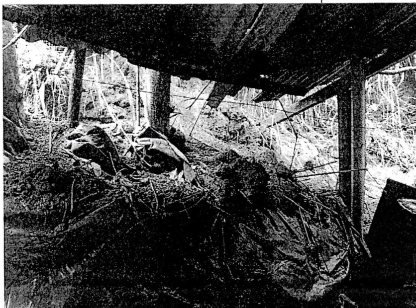
Figura N° 06 – Erosão na superfície do talude.
