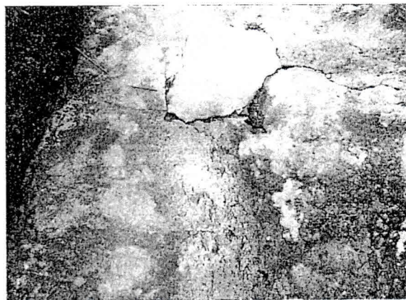
Figura N° 05 – Água infiltrando no pavimento.
